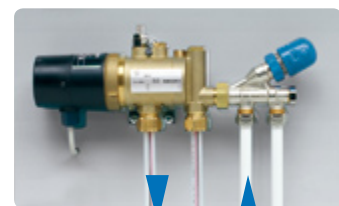
Anbindung der Flächenheizung Radiatorsystem
