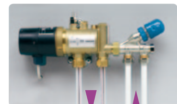
Anbindung der Flächenheizung Radiatorsystem
